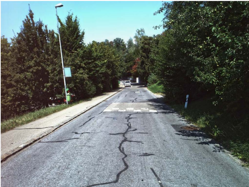
Bild 1: allgemeiner Zustand, viele Belagsrisse, abgesenkter, unebener Strassenrand, mangelhafte Oberfläche
