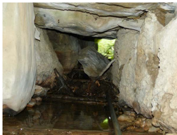
Verkeilter Stein, lose Sohle im Durchlass
