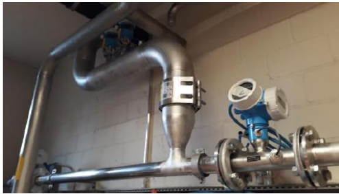
Neu eingebaute, druckkompensierte Gasmessung
