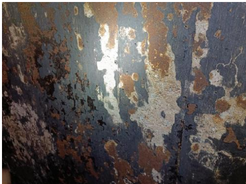
Oberfläche des Nachfaulturms ist auf ca. 50 % der Fläche bereits abgeblättert
