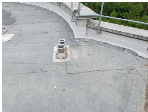
Neue Dämmung mit bituminöser Abdichtung und Anschluss mit Flüssigkunststoff an Beton Einstieg in den neu geschaffenen
