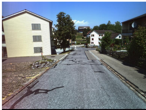
Neu Yorkstrasse: diverse Risse, defekte Abschlüsse
