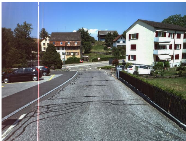
Neu Yorkstrasse: Netzrisse, Ablösungen, Ausmagerung
