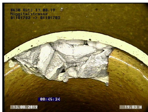
Bild 3: Abplatzung im Rohrscheitel
