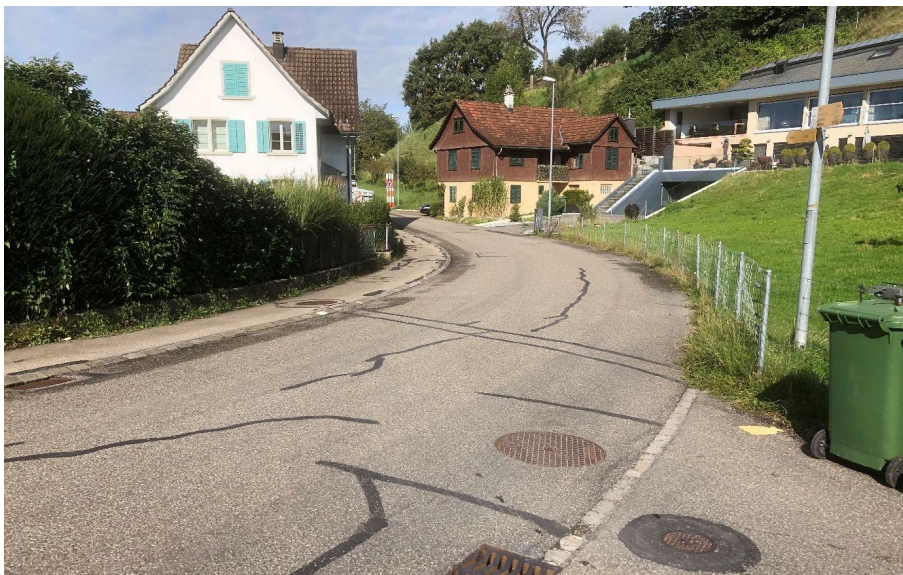
Bild 1: allgemeiner Zustand, viele Belagsrisse, abgesenkter, unebener Strassenrand, mangelhafte Oberfläche
