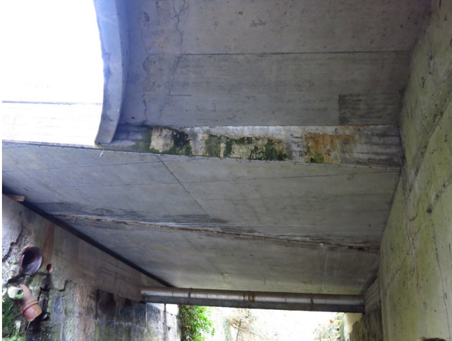
Abb. 7 Undichter Übergang Auskragungsplatte/ Leitungsquerung unter Fahrbahnplatte
