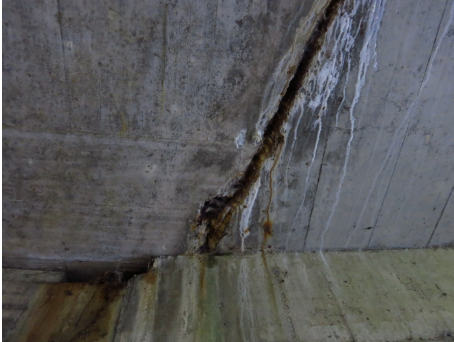
Abb. 5 Nassstellen, Korrosionsspuren, Kalkaussinterungen, Betonausbrüche unterhalb der Fuge im Bereich des Gehwegabsatzes beim Widerlager Süd.
