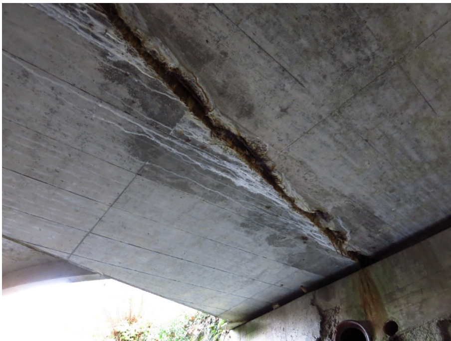
Abb. 4 Nassstellen, Korrosionsspuren, Kalkaussinterungen, Betonausbrüche unterhalb der Fuge im Bereich des Gehwegabsatzes beim Widerlager Nord.
