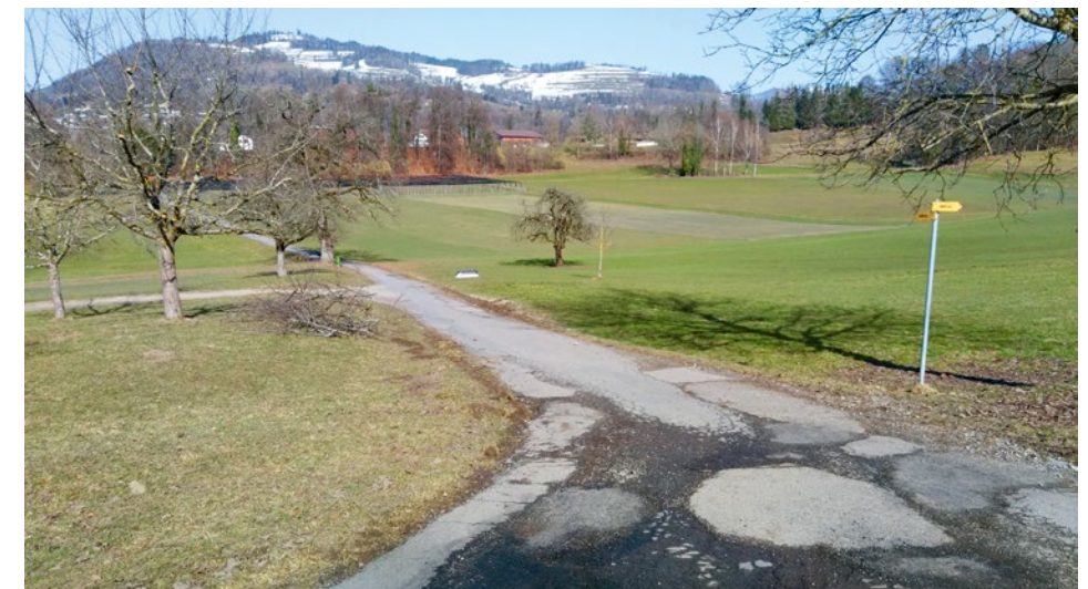
Ein Grossteil der Flurwege ist sanierungsbedürftig.
