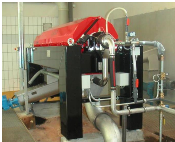
Foto: bestehende Dekanter Zentrifuge ARA Rüti
