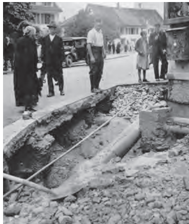
Zurück blieben enorme Schäden als Folge des Hochwassers wie hier am Löwenplatz.
