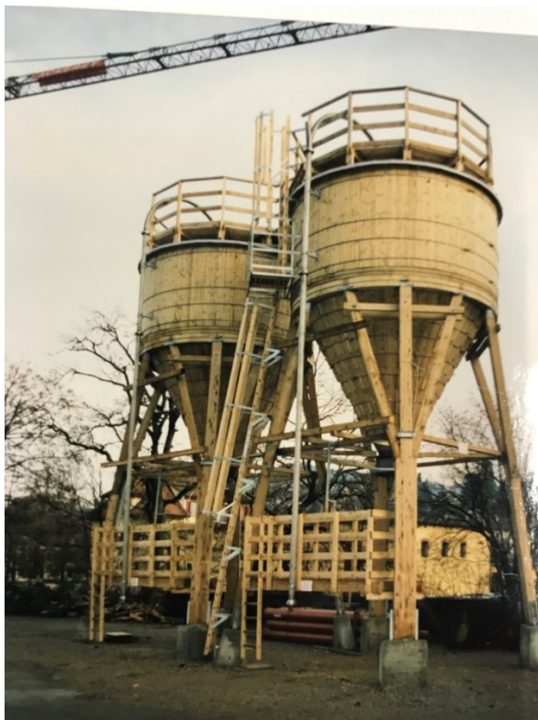
Aufnahme von 1992, neue Siloanlage 2 x 50 m 3
