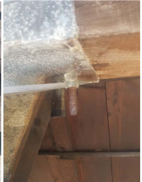
Korrosion an statischen Verbindungen
