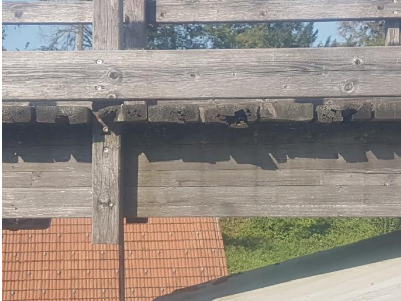
Fäulnis und Pilzbefall am Dachlaufsteg
